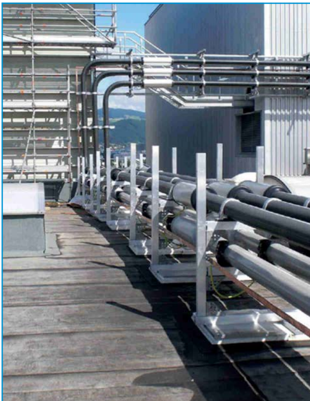
Austria - GUD Linz: 12kV - 4500A
